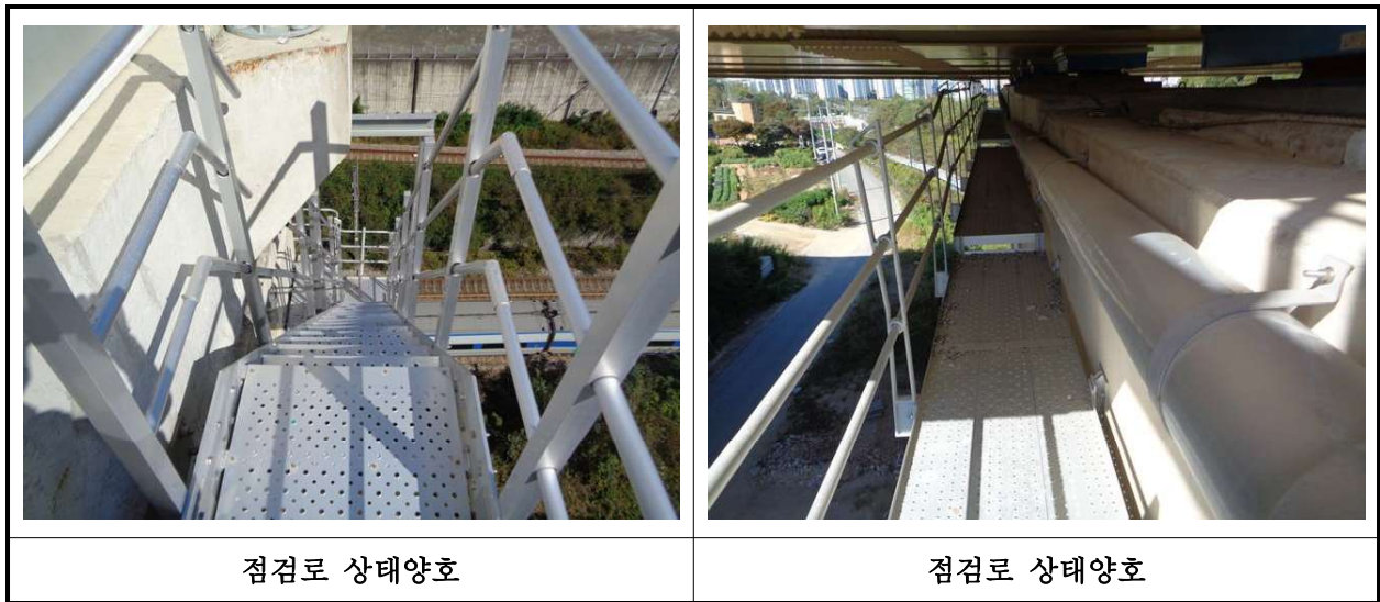
【사진 6.3.26】 교량 점검시설 손상현황
